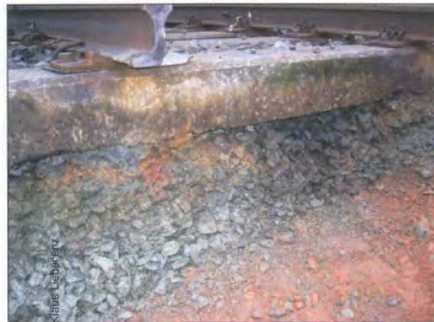
Exemple de pollution de la couche de ballast
